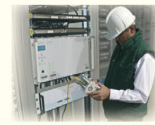
Instalación DTTV en el prestigioso Teatro Liceo de Barcelona
